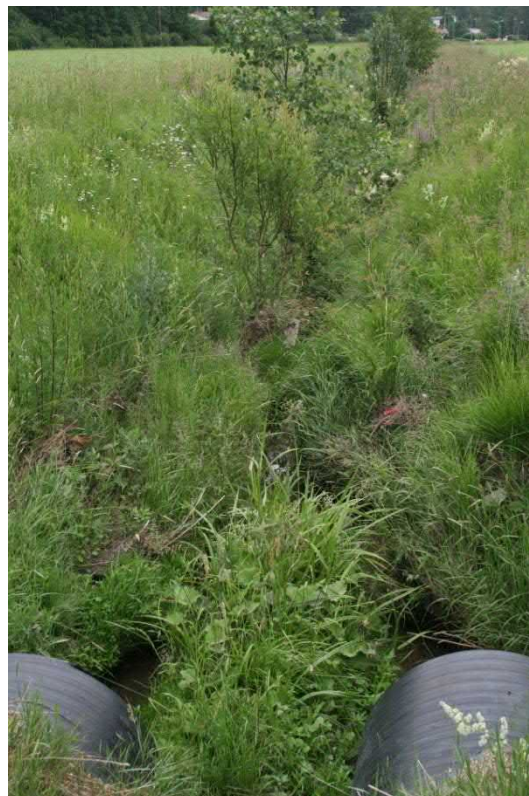
Kuva 34. Uomassa on paikoin penkkasortumia.
