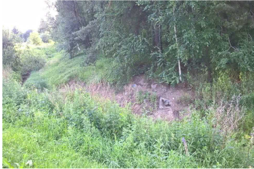
Kuva 53. Sivu-uoman yläosalla on voimakasta eroosiota.
