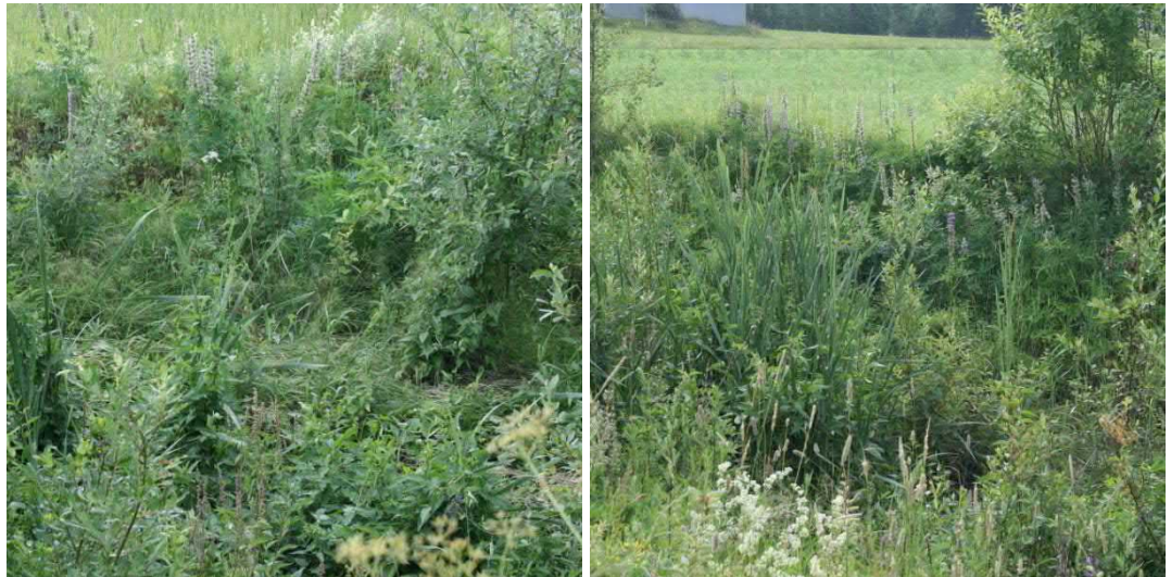
Kuva 79. Uoma on täysin kasvillisuuden peitossa.
