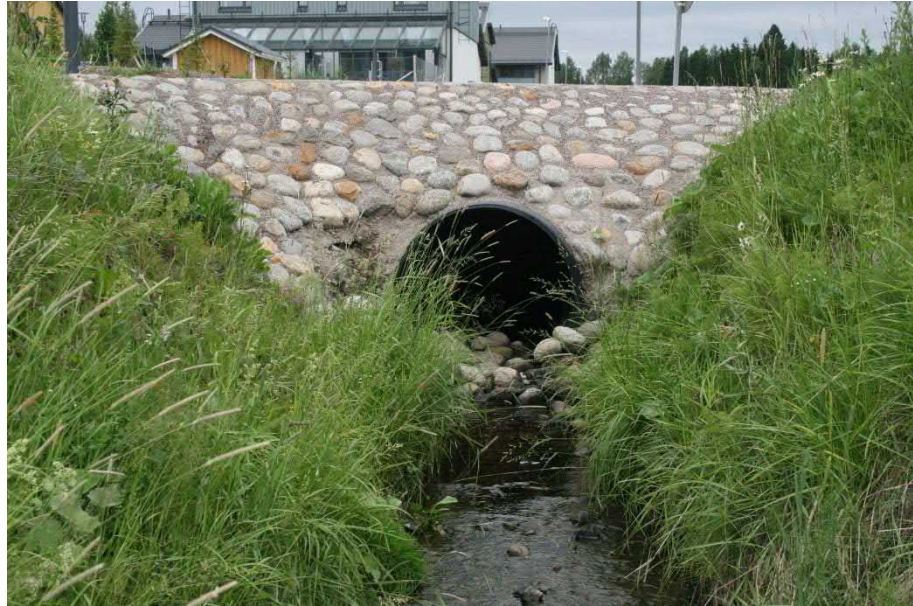
Kuva 33. Eriksnäsinöja alittaa Ristikadun isossa muovirummussa, jonka jälkeen uoma on leveä ja syvä.
