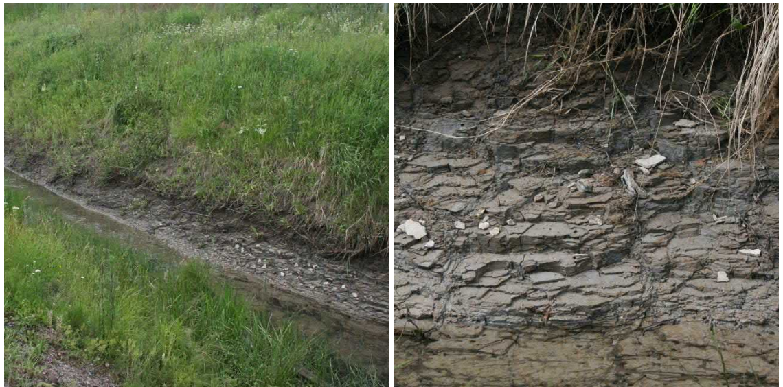
Kuva 74. Radanvarressa kuivakuorisavi on kuivunut ja lohkeillut.
