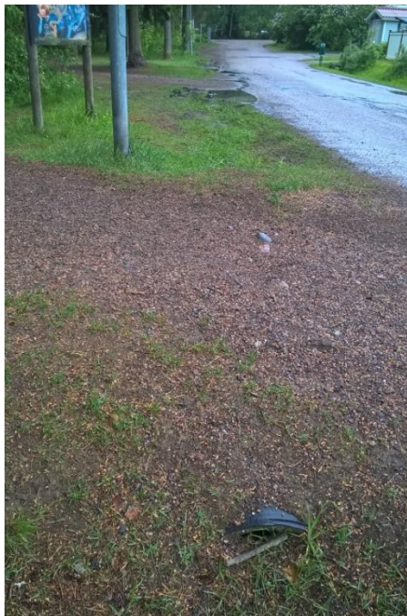
Kuva 4. Koulukujan alta etelään tuleva rumpu sekä Koulukujan ja lammen välissä virkistyreitin alittava rumpu olivat täynnä maa-ainesta.
