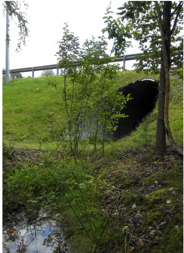
Kuva 3.5. Lepolassa Poikkitie alii on rakennettu alikuku-tunneli, joka mahdollistaa eläinten ja ihmisten liikkumisen.
